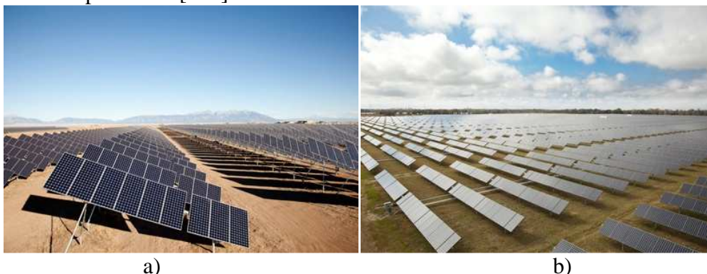
Figura 1.18. Câmp de șiruri fotovoltaice: a) 17MW tracker T20 SunPower la Alamosa, Colorado; b) 35MW tracker T0 SunPower la DeSoto, Florida [119].
