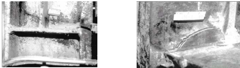
Fig.6 - Exemple de cedări în urma investigațiilor a) cedarea sudurii cu fisurarea inferioară grinzii într-o îmbinare de grindă - stâlp; b) cedarea sudurii de la partea inferioară a îmbinării, cu propagarea fisurilor pe talpa și inima stâlpului
